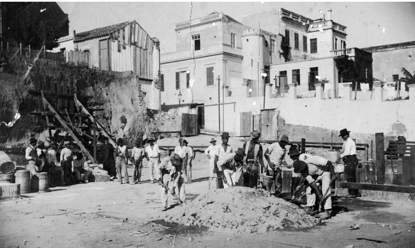
▲ Foto 41. [1921] Preparação da argamassa, possivelmente para a construção do arrimo, cujo barranco foi escorado com mãos francesas e tábuas de madeira.
