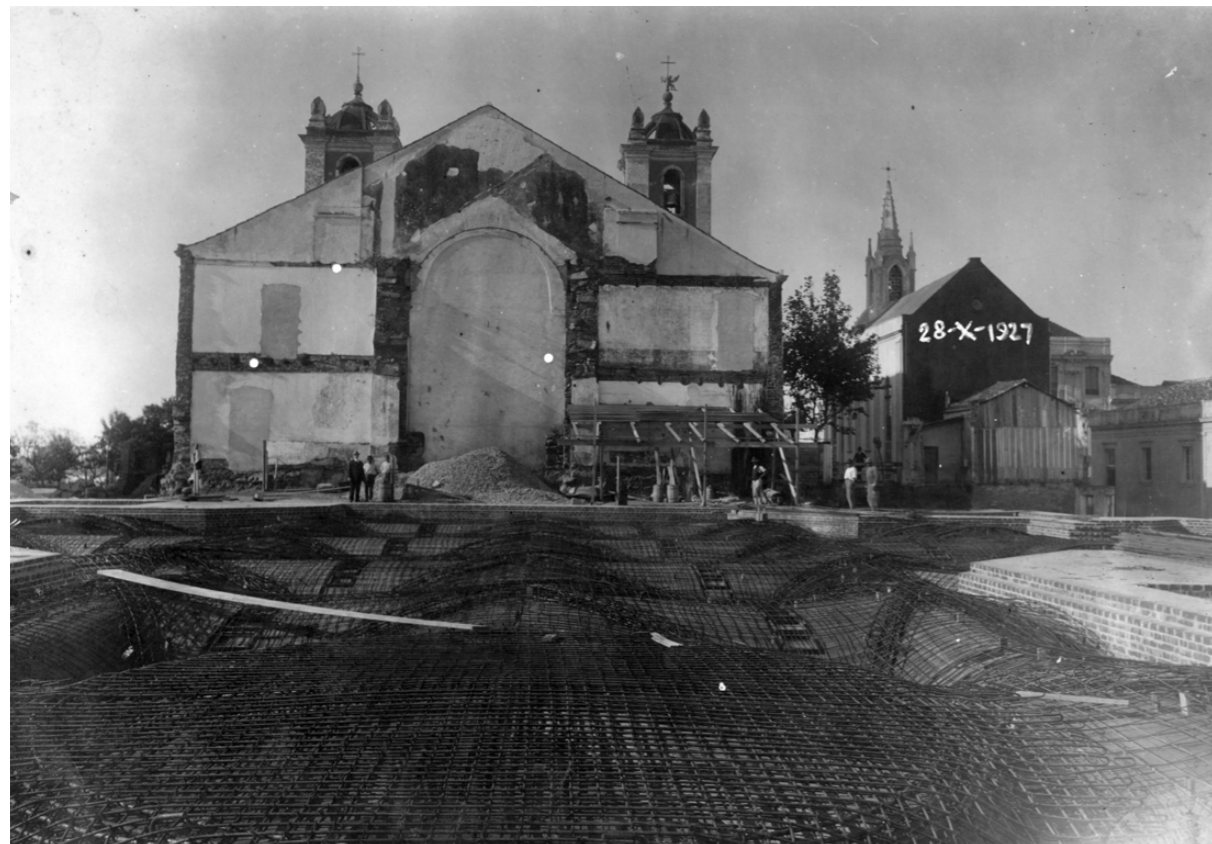
▲ Foto 68. [28/10/1927] Ferragens da estrutura do entrepiso que cobre a cripta. Ao fundo, rente ao que restou de velha matriz, os insumos do concreto que em breve serão espalhados sobre a ferragem. Em primeiro plano, a caixaria de madeira abaixo dos ferros moldará as abóbadas e arcos com caixotões que adornam o teto da cripta.
