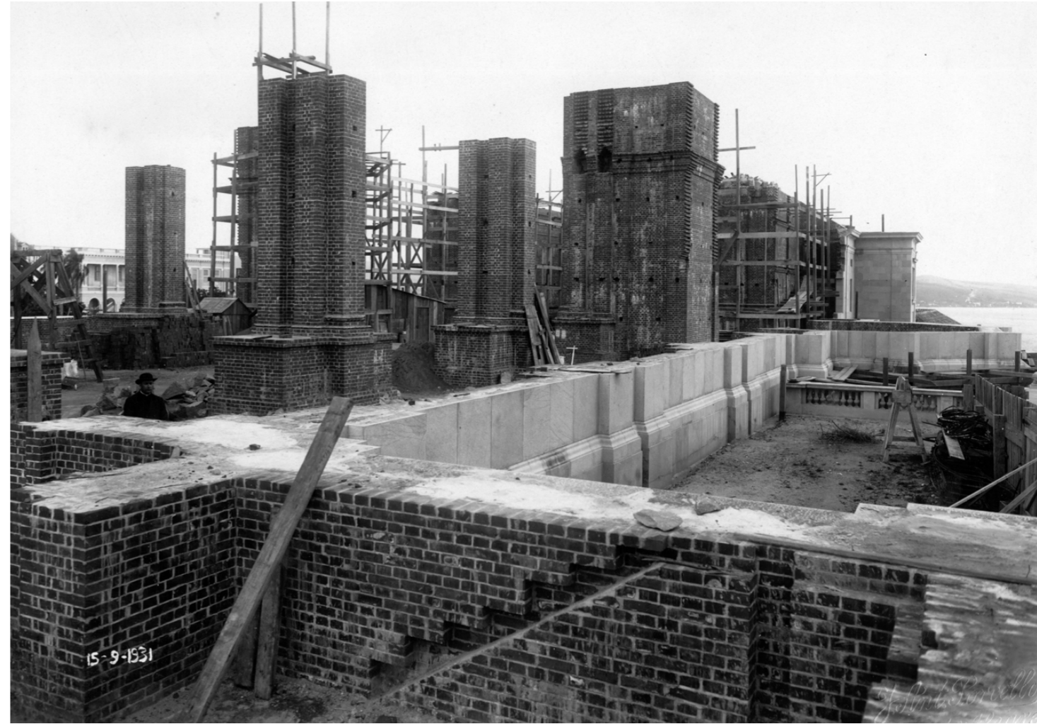
▲ Foto 78. Mesmo com a redução de operários e as poucas arrecadações, as obras continuaram. Em primeiro plano, a construção da torre oeste, com sistema construtivo misto (alvenaria de tijolos, concreto e placa de pedra), e a espera para o engaste da escadaria em concreto armado, com a função de dar acesso ao compartimento do sino. Em segundo plano, a elevação das capelas intercomunicantes da nave em alvenaria de tijolos.
